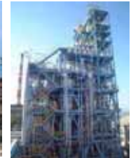
合成ガス精製プラント
